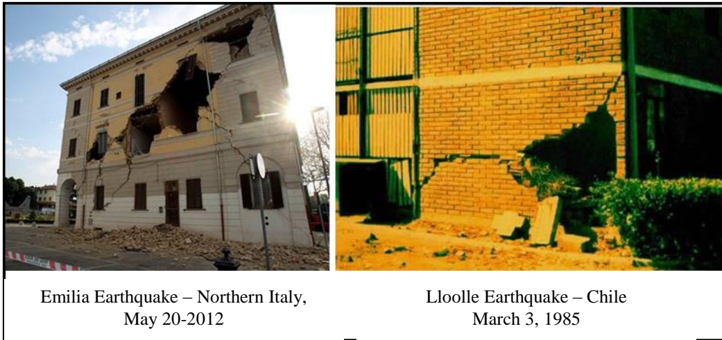
شکل ۱-۷- تخریب خارج از صفحه دیوارهای بنایی غیرمسلح در زلزله‌های امیلیا و لولله
